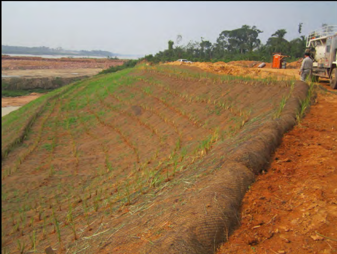
UHE JIRAU – Usina Hidroelétrica, Porto Velho, RO, Brasil - 2012.
